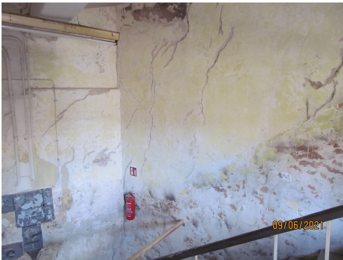
Zdj.5.9 Spękania ściany szczytowej południowej w rejonie klatki schodowej.
