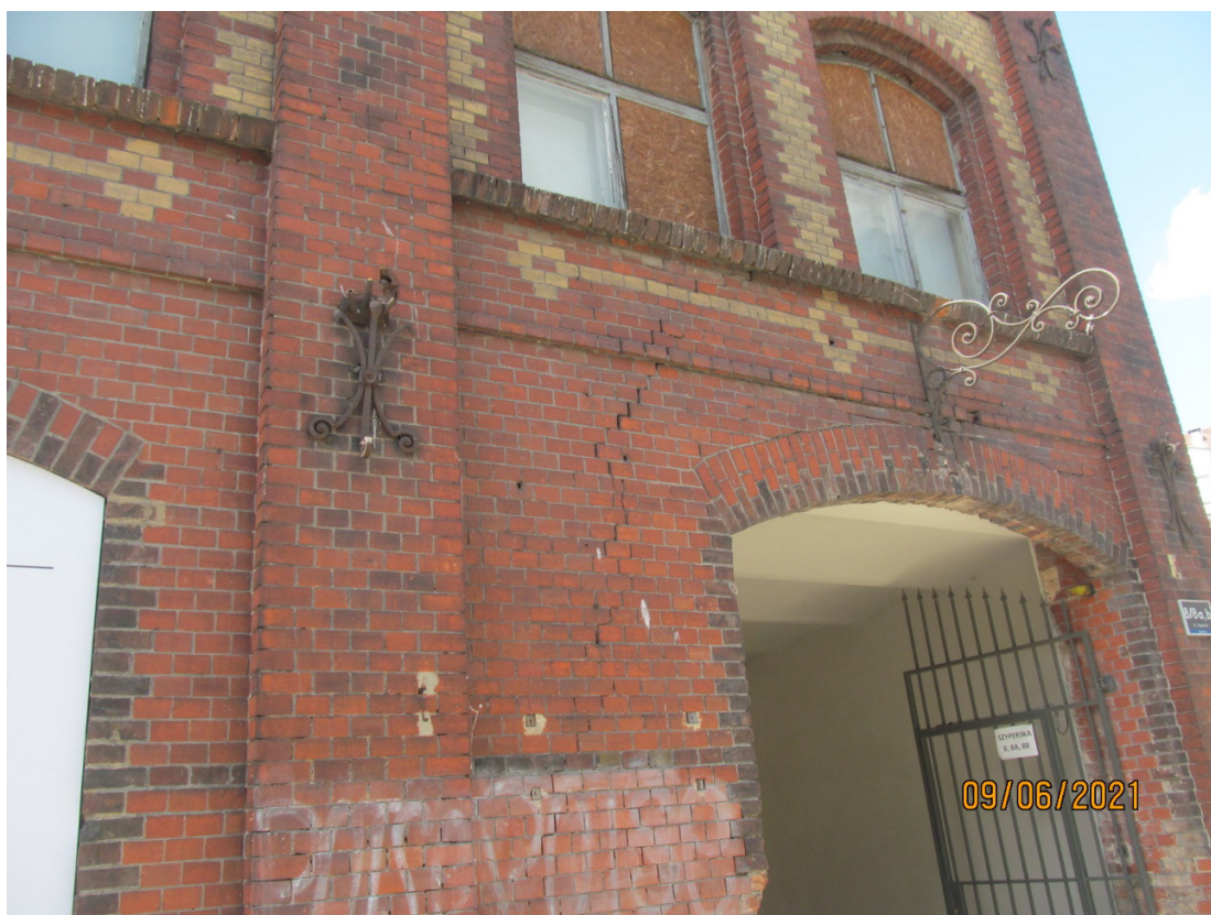
Zdj.5.11 Przykład spękania widocznego na elewacji z licową cegłą.
