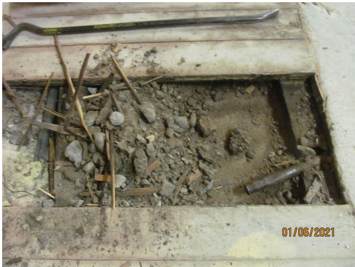
Zdj.5.3 Odkrywka posadzkowa. Widoczny gruz leżący na sklepieniu odcinkowym.
