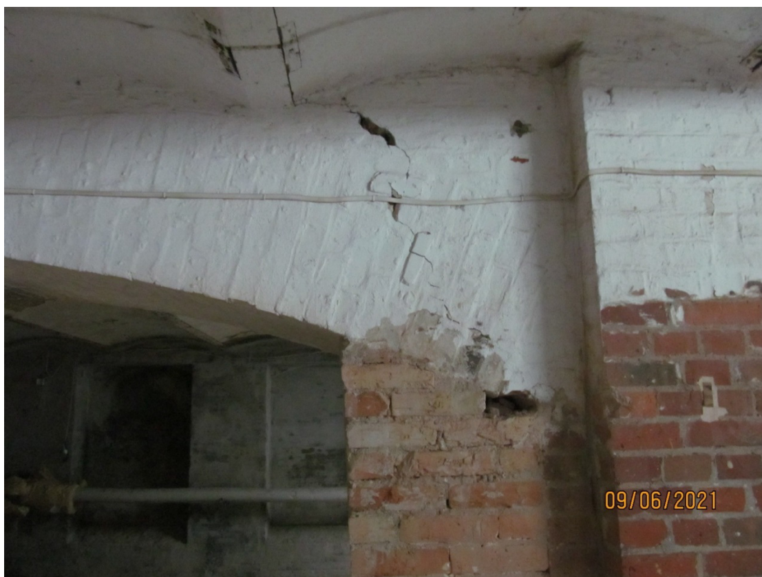
Zdj.5.2 Łuk odcinkowy podpiwniczenia. Widoczne pęknięcie łuku oraz jego podmurowanie.
