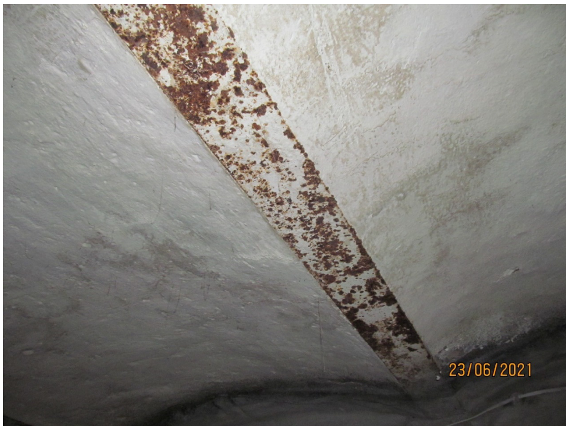
Zdj.5.1 Strop odcinkowy kondygnacji podziemnej. Widoczny proces korozji powierzchni stopki belki stropowej.
