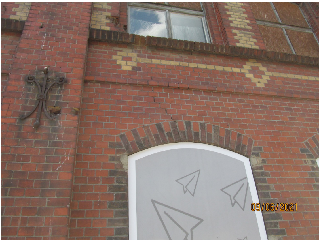
Zdj.5.12 Przykład spękania widocznego na elewacji z licowa cegłą.
