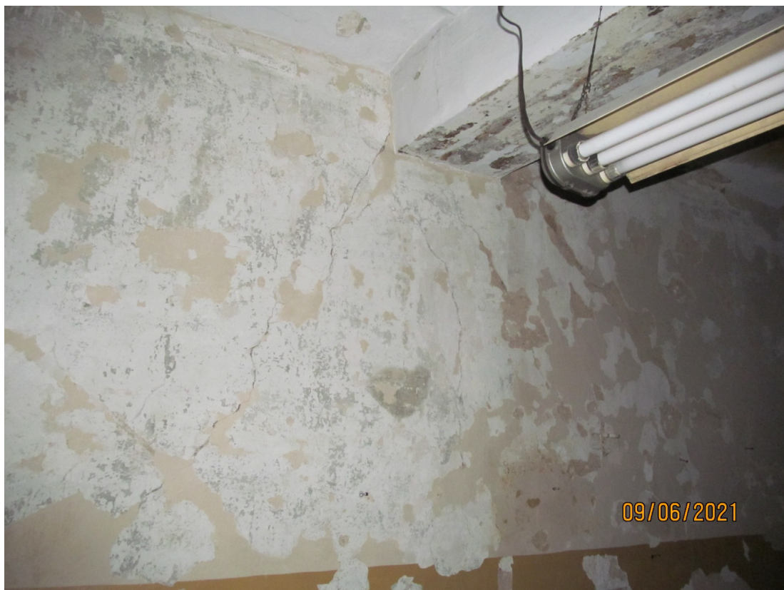
Zdj.5.10 Spękania ściany szczytowej północnej w rejonie poniżej oparcia rygła ramy.
