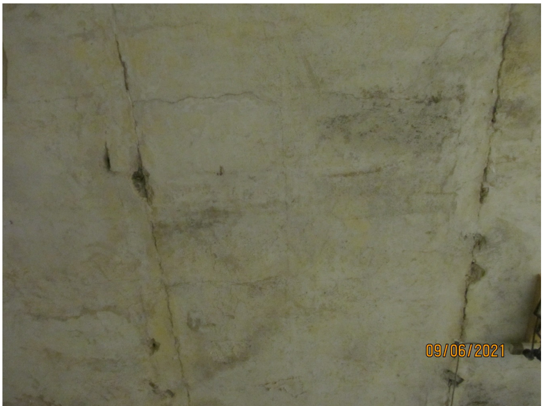
Zdj.5.5 Spód stropu DMS. Widoczne spękania wzdłuż żeber stropowych i inne.
