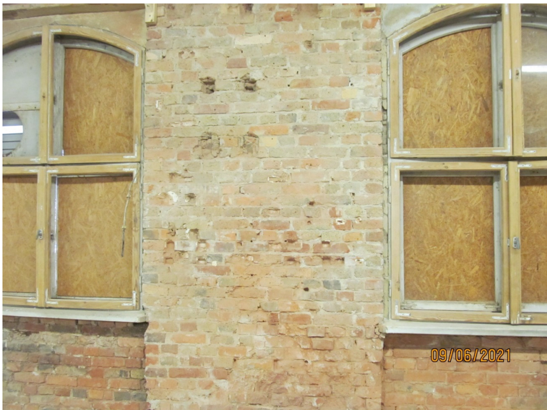
Zdj.5.13 Widok lica wewnętrznego ściany zewnętrznej IIp. bez tynku. Widoczne różne drobne uszkodzenia muru.
