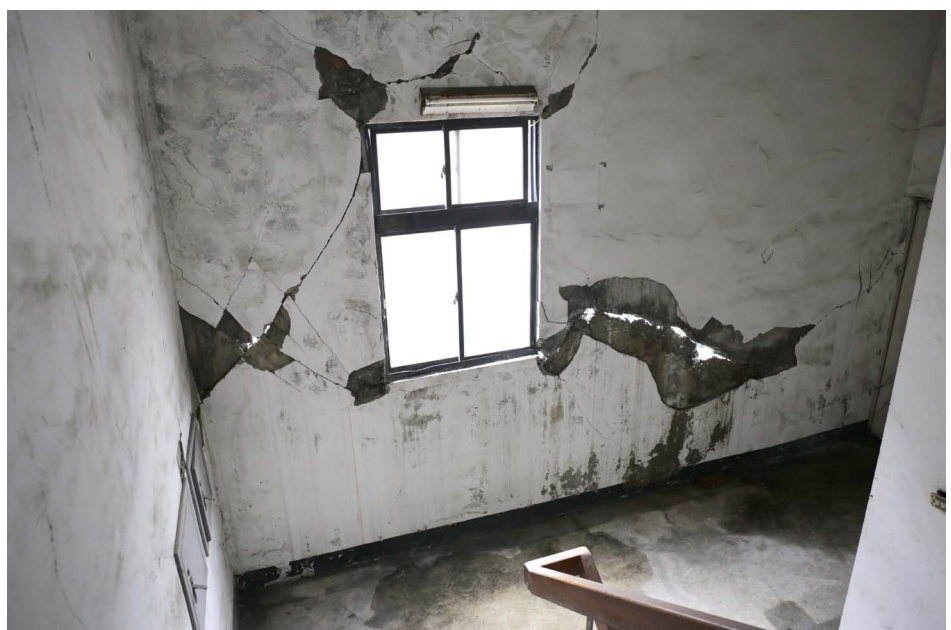
Budynek uszkodzony w trzęsieniu ziemi, Chiayi, Tajwan, 2018
